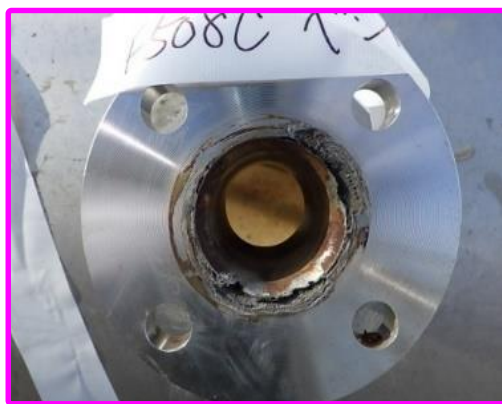
ベント管フランジ部（交換修理前）
