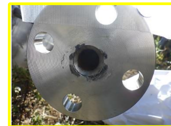
計装配管フランジ部の腐食状況
