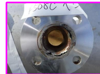
ベント管フランジ部の腐食状況
