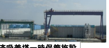
使用済吸着塔一時保管施設
