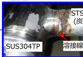
<補修前> <②の外表面腐食・補修状況>
