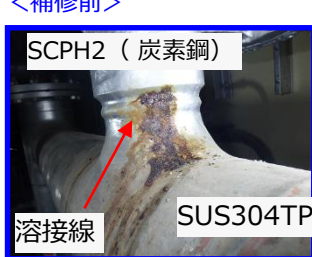
<⑫の外表面腐食・補修状況>
