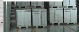
固体廃棄物貯蔵庫
