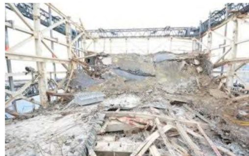
南側崩落屋根の状況
