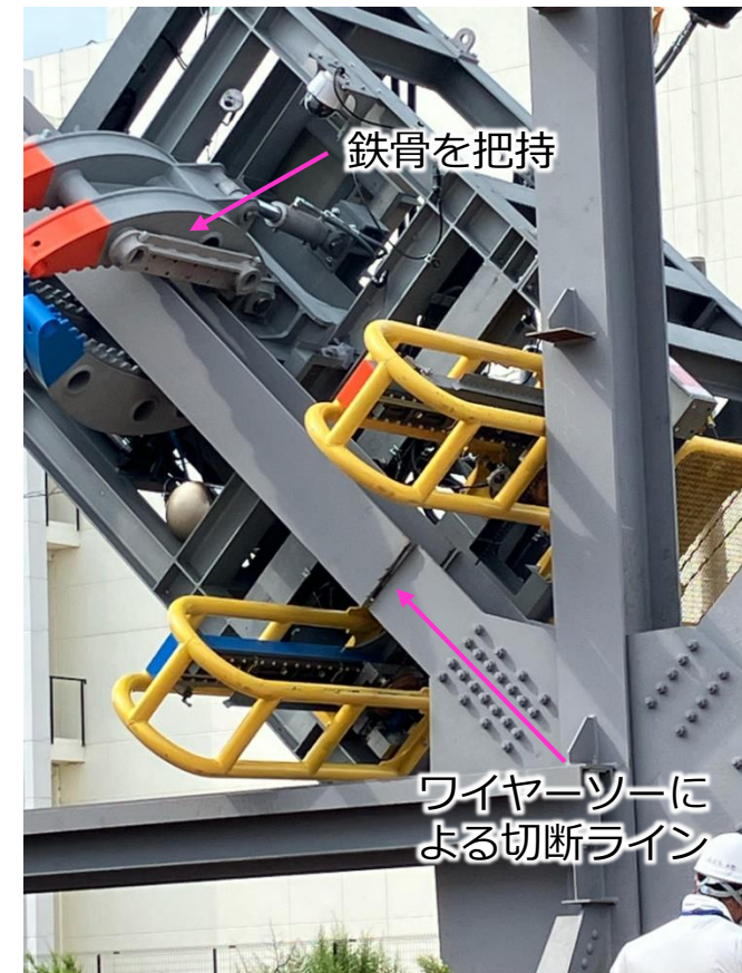
ブレース切断状況(アップ) (撮影:8月22日)
