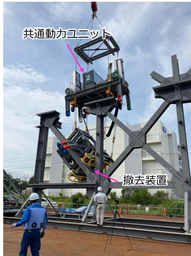
ブレース切断状況 (撮影:8月22日)
