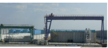
使用済吸着塔一時保管施設
