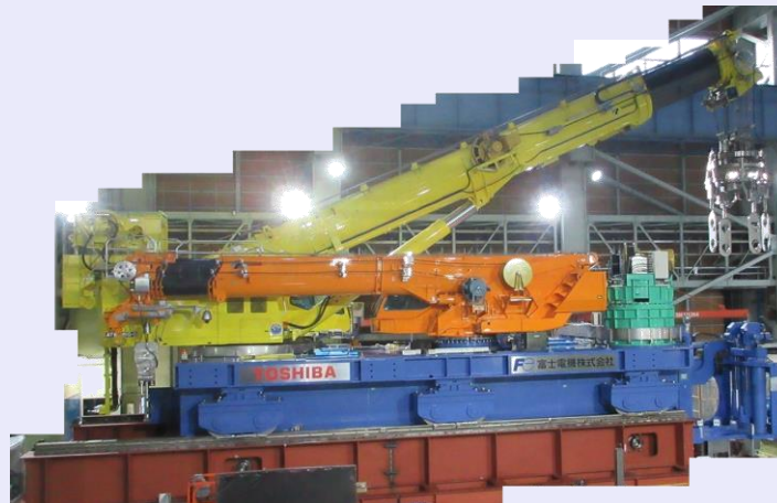
<燃料取扱設備>
