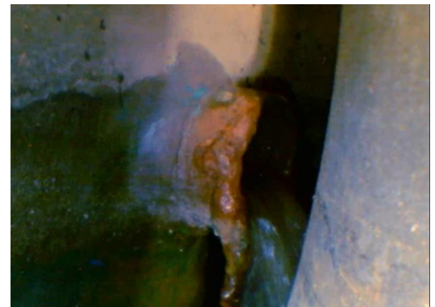
ピット南東側壁に確認された配管からの流入状況 (散水中)10
