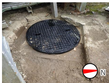
マンホール蓋 (②)
