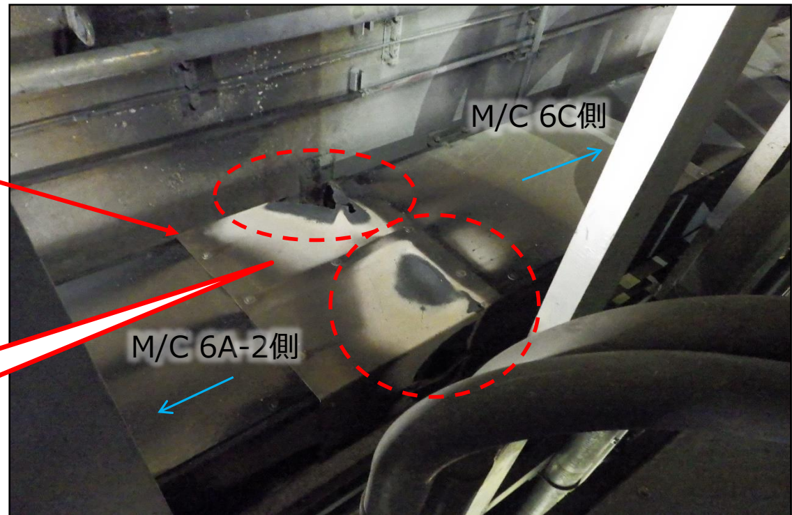
相非分割母線(上から見た状況)
