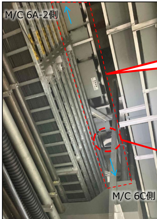
相非分割母線(見上げた状況)
