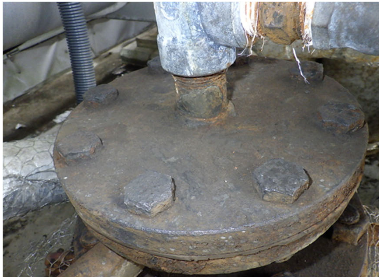
清掃前の凍結管
