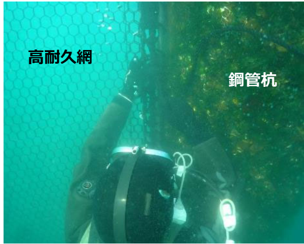
図7. 作業員が水中で高耐久網を鋼管杭に 設置している状況 (2024年1月13日撮影)
