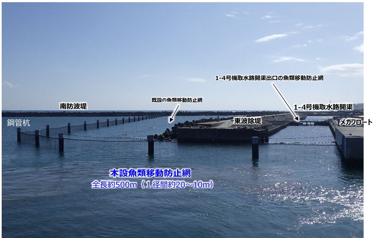
図2.東波除堤魚類移動防止網リプレイス工事の網設置状況（2024年2月17日撮影）
