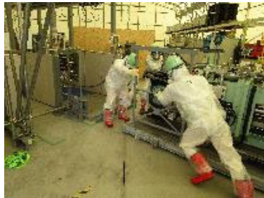
堆積物除去装置 (低圧水) 設置
