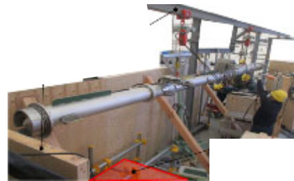
スプレー治具設置 ※X-53ペネに接続
