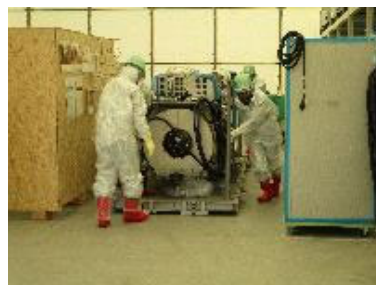
堆積物除去装置 （高圧水、AWJ）設置
