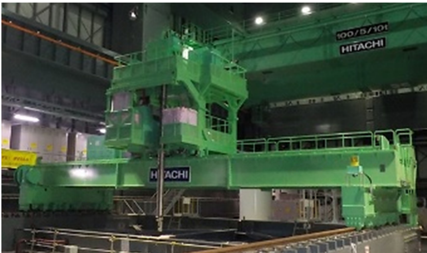
有効活用する4号機燃料取扱機
