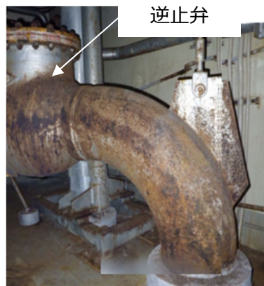
既設CUWライン (水位計取付箇所)
