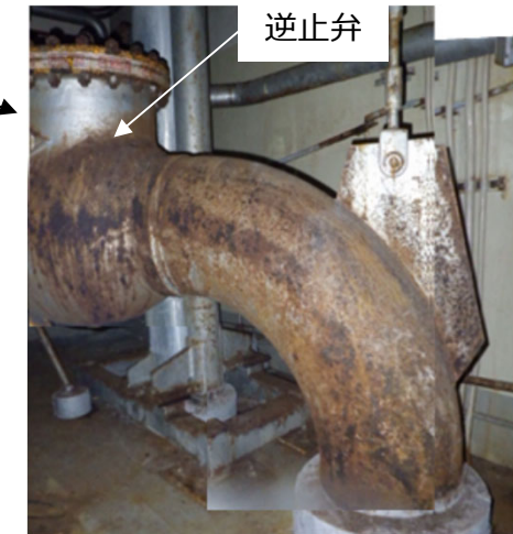
既設CUW配管
