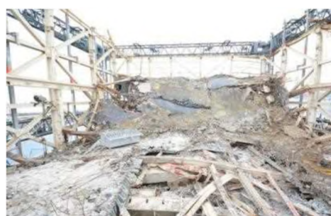
南側崩落屋根の状況
