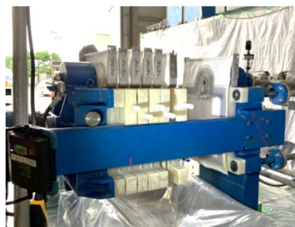
脱水処理(脱水物取出し工程)
