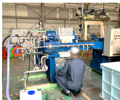
脱水処理(圧搾工程)
