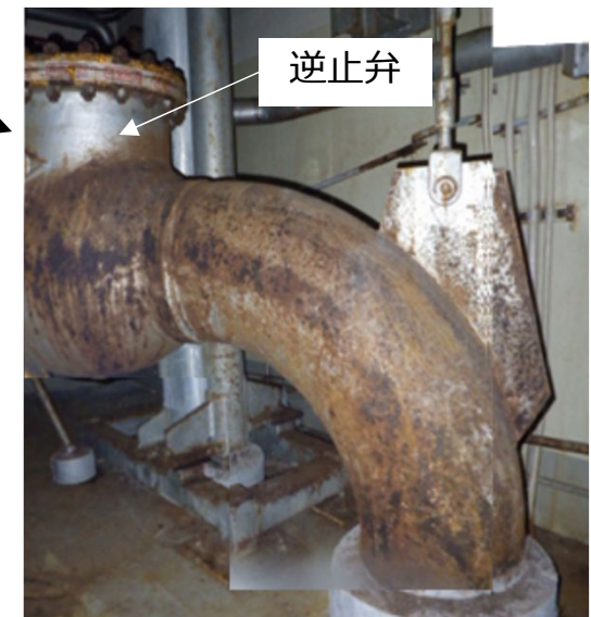
既設CUW配管
