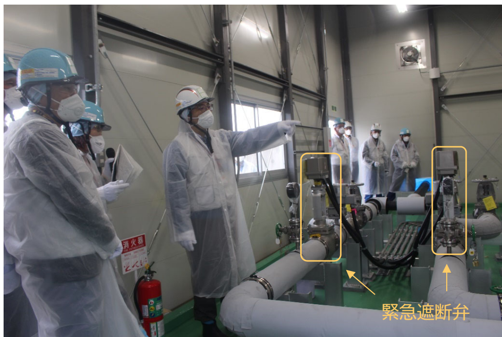
国際原子力機関（IAEA）による緊急遮断弁の確認 [2023年6月2日撮影]
