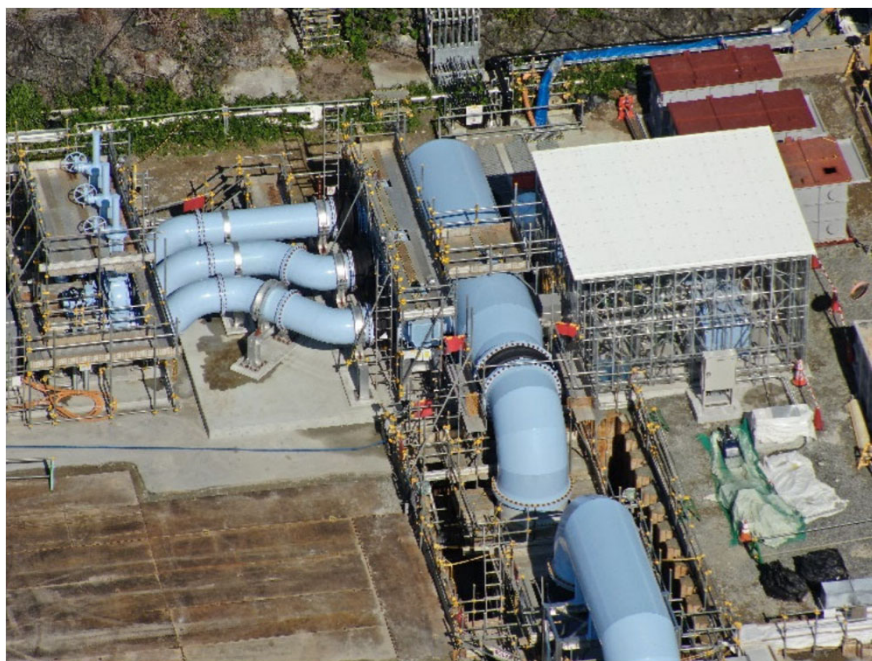
海水移送配管と海水配管ヘッダ (海水配管ヘッダ：ALPS処理水を海水により混合希釈する) [2023年6月25日撮影]
