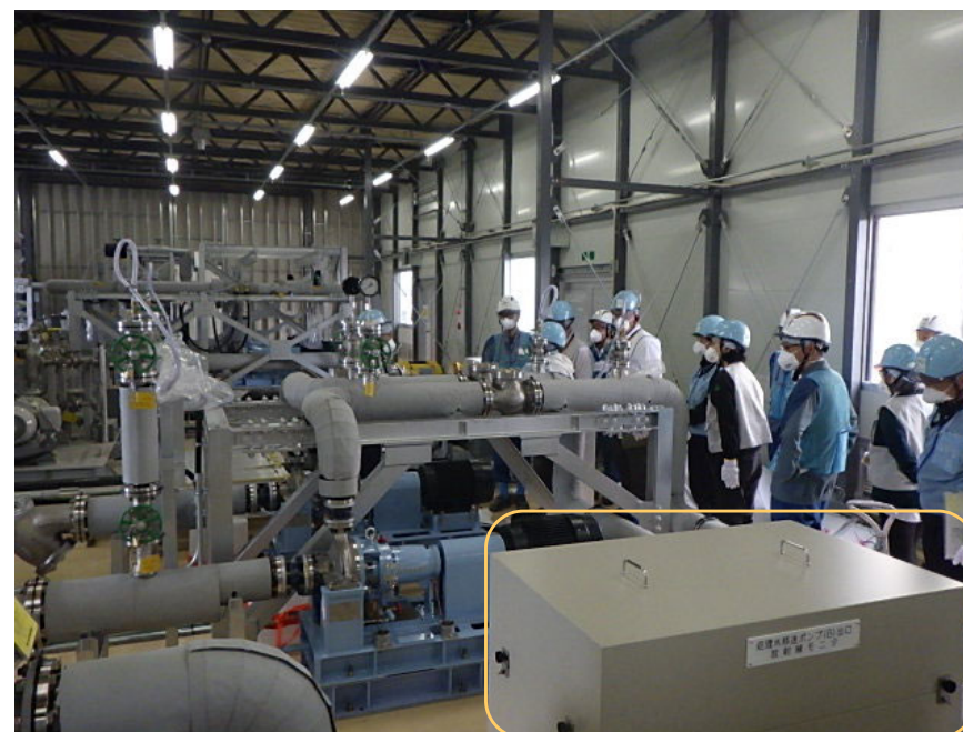
国際原子力機関（IAEA）による移送設備の確認 [2023年5月24日撮影]
