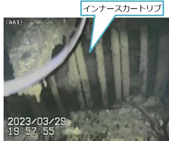
ポイント⑦の状況
