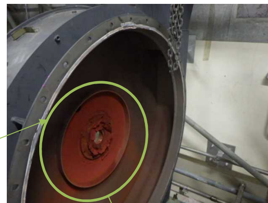
ブロアケーシング内部の腐食状況
