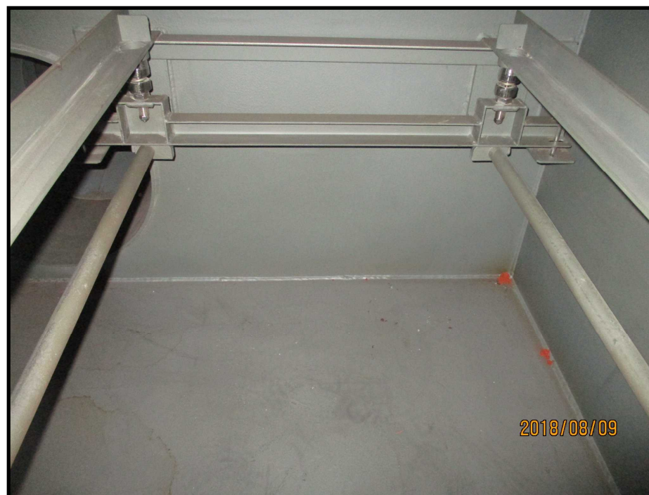
排ガスフィルター（B）内部写真
