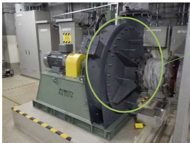
排ガス補助ブロア外観
