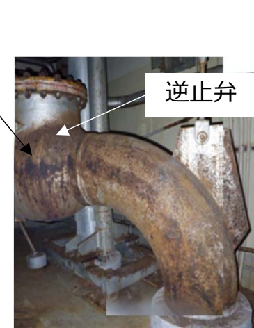
既設CUW配管
