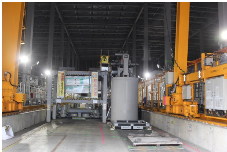
増設多核種除去設備 (ALPS)
