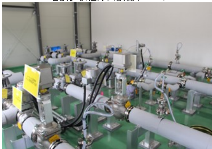
ALPS処理水移送設備 (緊急遮断弁)
