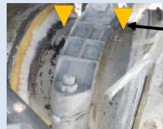
配管レベル計測箇所
