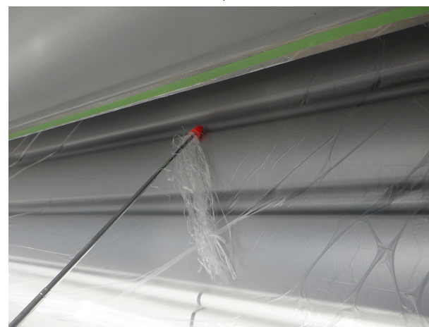
目張り実施中
