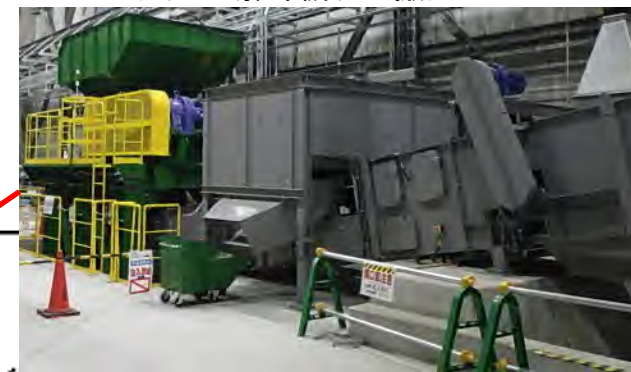
コンクリート解砕機及び搬出コンベア
