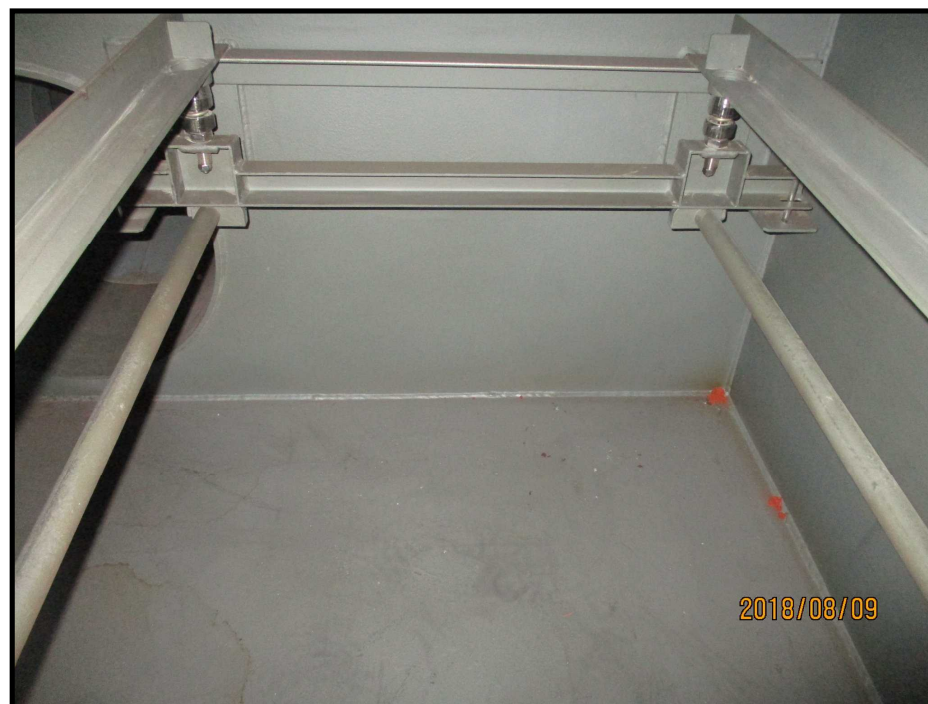
排ガスフィルター（B）内部写真
