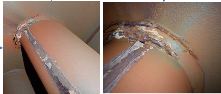
①バグフィルタ逆洗用圧縮空気配管と天板の付根部
