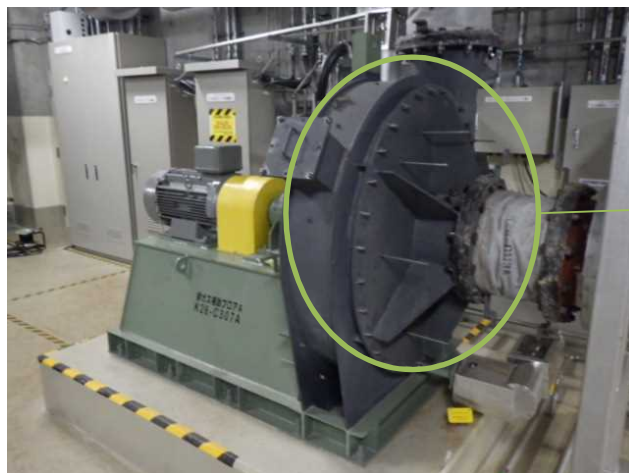
排ガス補助ブロア外観
