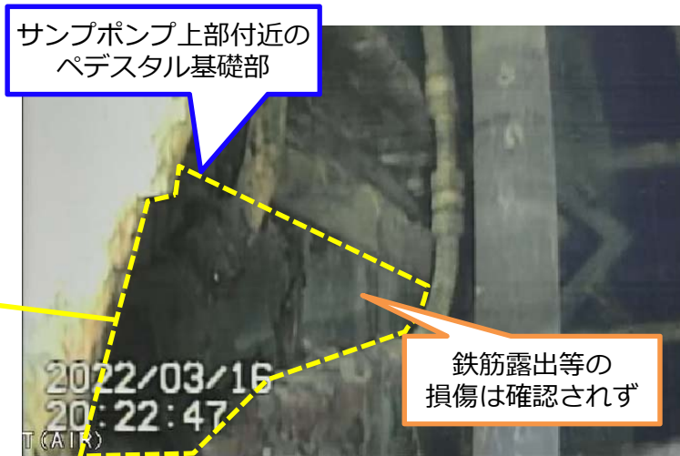
写真5. 遮へい板裏ペDESTAL壁面(堆積物上部)
