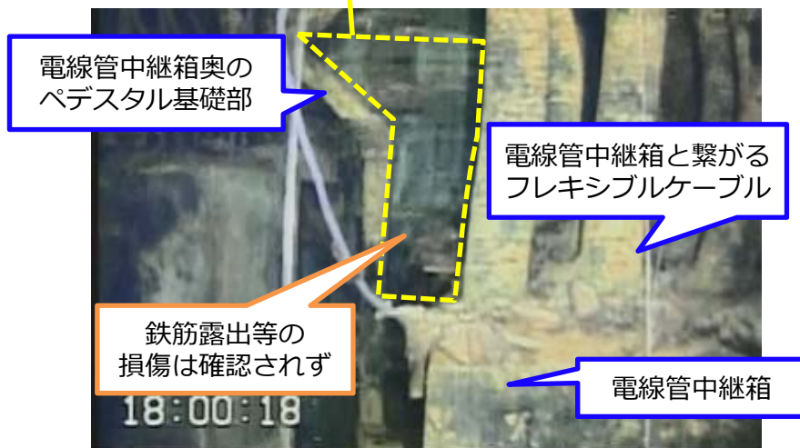
写真4. 中継箱奥ペDESTAL壁面(堆積物上部)
