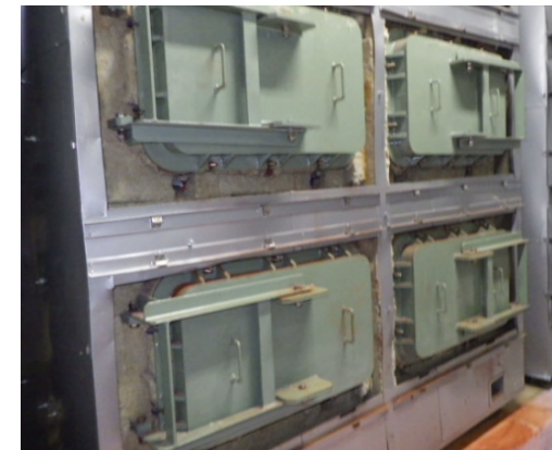
排ガスフィルタ外観
