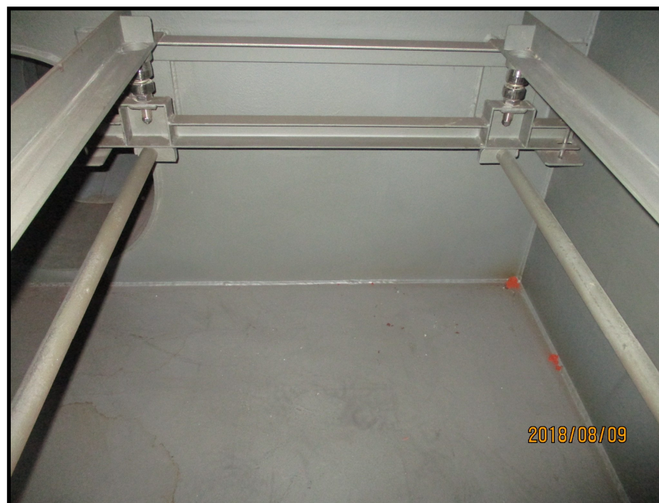
排ガスフィルター（B）内部写真
