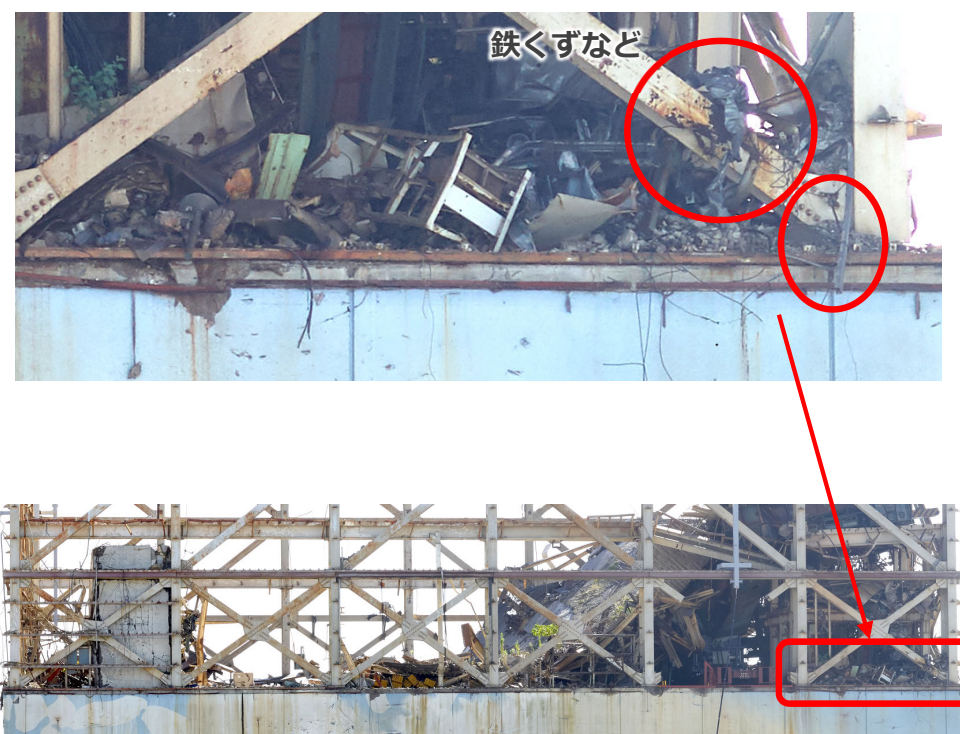
はみ出しガレキ状況（西面）
