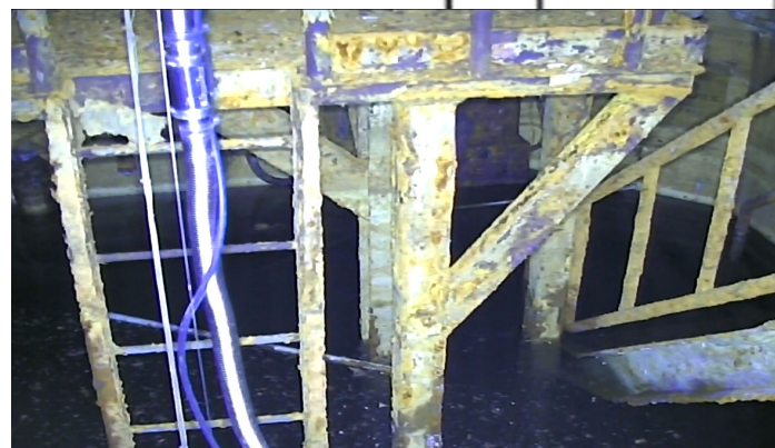
②西 (階段、空調設備)
