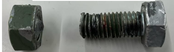
①電動機ベース据付ボルト(M12:SS400)破断箇所(2か所)及び浮き上がり状態(ワッシャの割れも一部確認)
