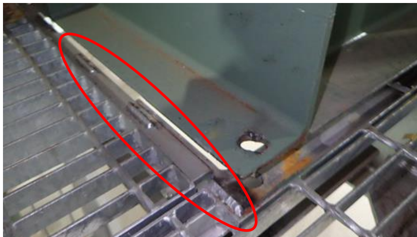
②電動機ベース溶接部(ずれ止め用)割れ
