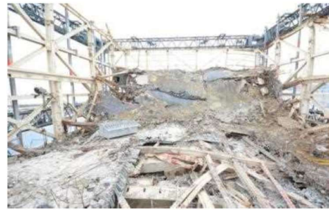
南側崩落屋根の状況
