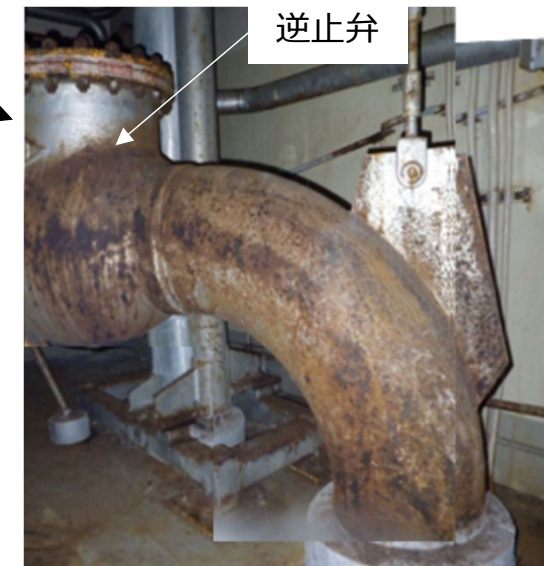
既設CUW配管
