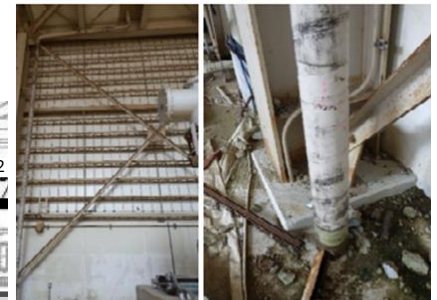
3・4号超高压開閉所 雨水配管
