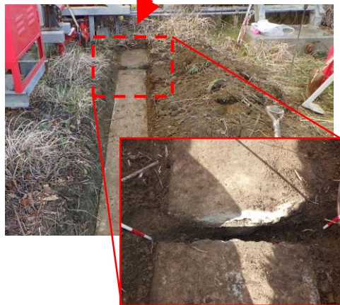
地下側溝損傷箇所 現場写真
