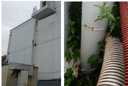
ホールドアップ建屋 雨水排水
