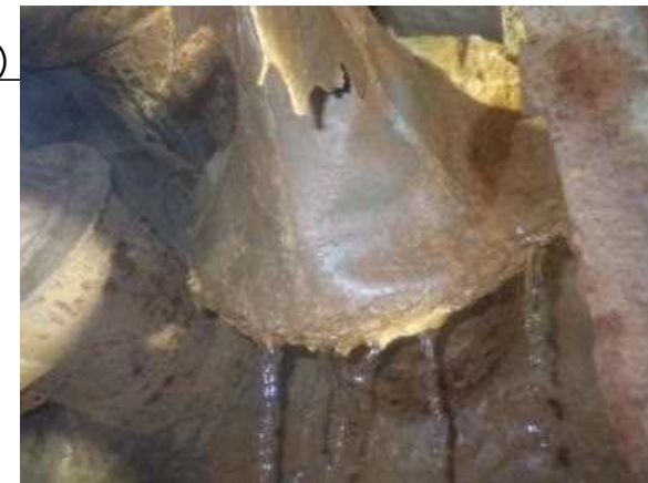
建屋間ギャップ貫通配管部地下水流入状況 (2021.7焼却建屋と工作建屋の貫通配管部)
