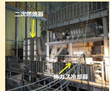
二次燃焼器 排ガス冷却器
