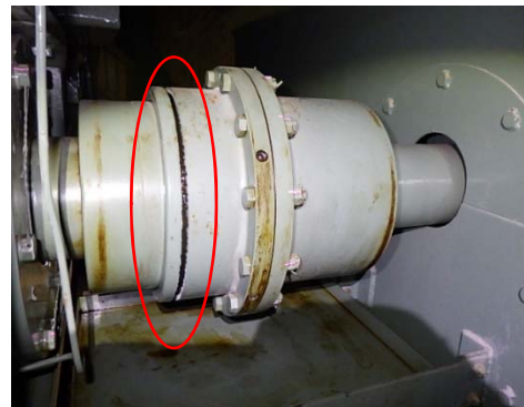
ギアカップリングカバー損傷部
