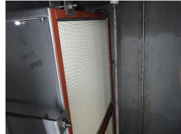
フィルタトレイン内部の様子 (例：3号機A系のHEPAフィルタ)
