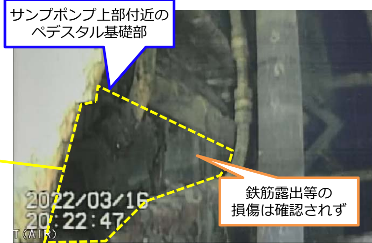
写真5. 遮へい板裏ペDESTAL壁面(堆積物上部)
