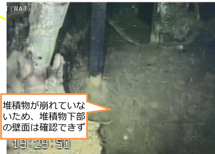
写真6. 遮へい板裏ペDESTAL壁面 (堆積物周辺)
