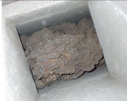
B: 主灰取り出しボックス下部シュート内部
