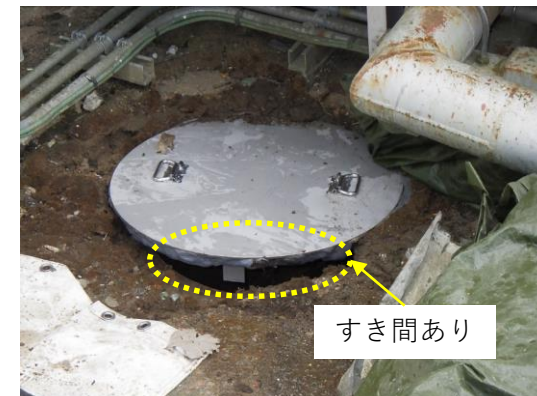
サンプ南東部のマンホール
