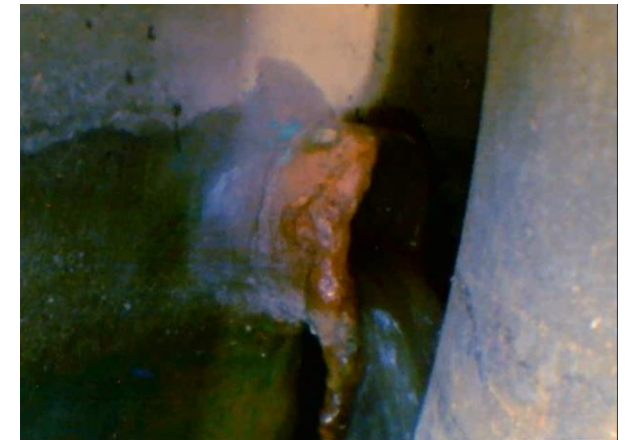
ピット南東側壁に確認された配管からの流入状況（散水中）3
