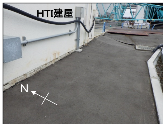
HTI建屋南側沈下状況
