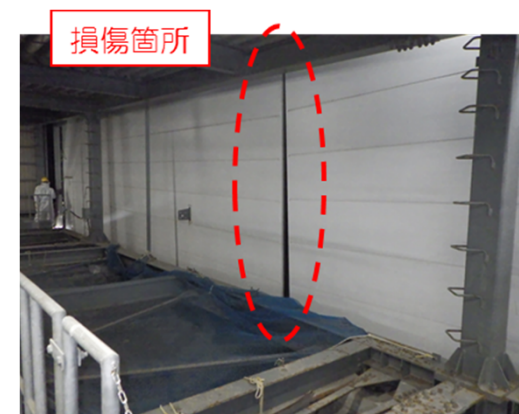
【写真③】 損傷を確認した外壁 (外側から撮影)
