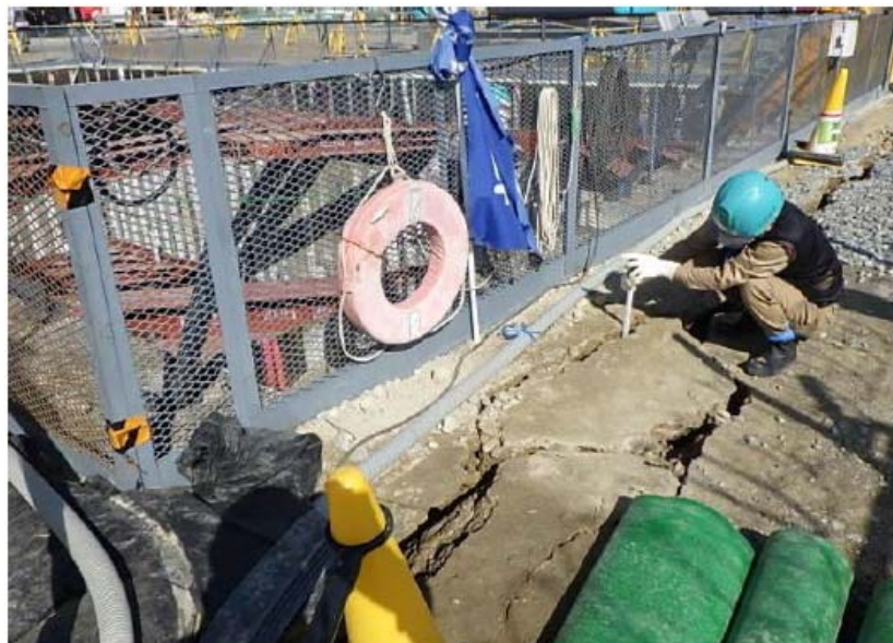
写真① 地震後の地割れの状況（下流水槽近傍付近）
