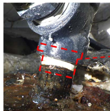
【凍結管継手部
