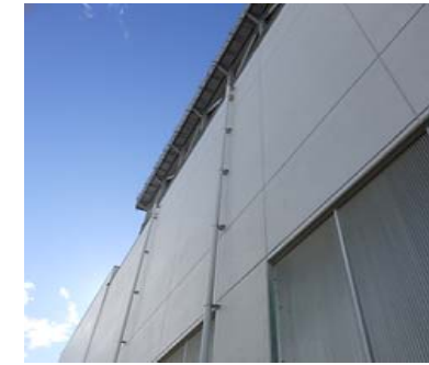
共用プール建屋 屋根排水設備
