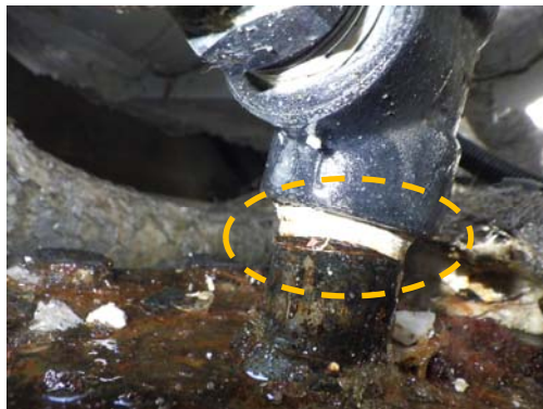
凍結管継手部 漏えい箇所
