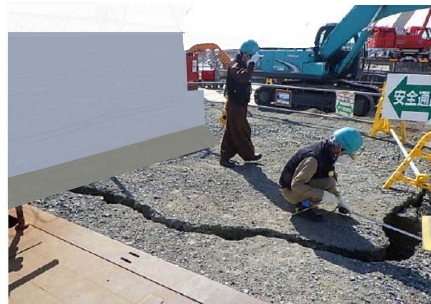
写真② 地震後の地割れの状況（下流水槽周辺付近）
