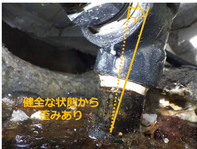
【50-5T 凍結管継手部歪みの目視確認】
