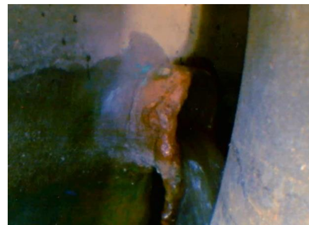
ピット南東側壁に確認された配管からの流入状況（散水中）
