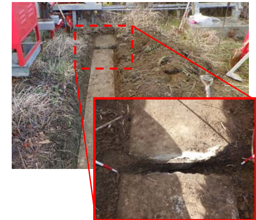
雨水排水側溝の損傷箇所
