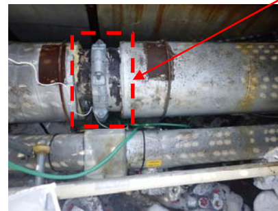
ブライン供給配管 ブライン漏えい箇所 (保温取り外し後)
