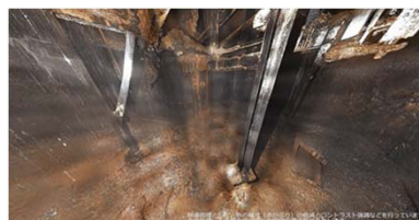
ベDESTAL底部の状況（パノラマ合成処理後）
