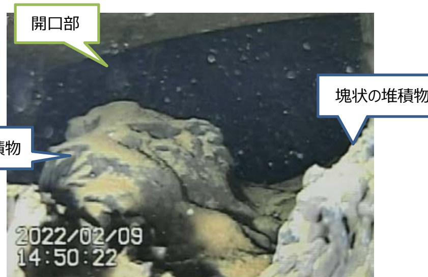
C. ペDESTAL開口部内部
