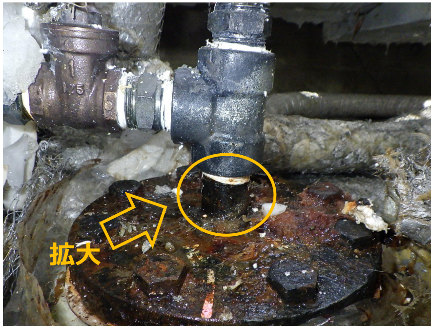
【50-5Tの凍結管頭部写真】
