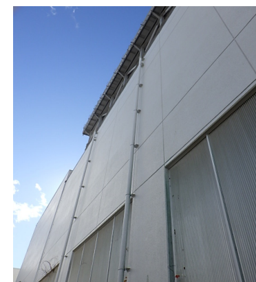
雨水排水設備
