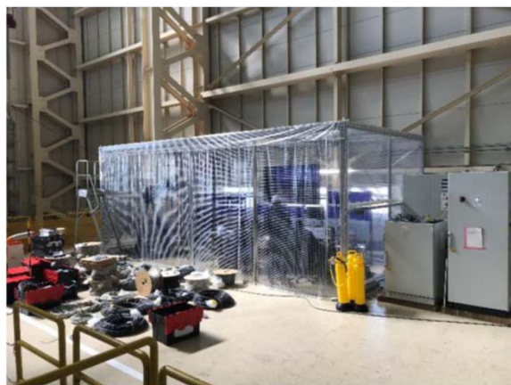
コントロールルーム設置状況
