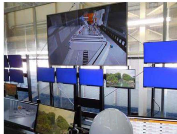
コントロールルーム内状況
