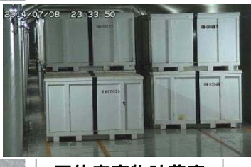
固体廃棄物貯蔵庫
