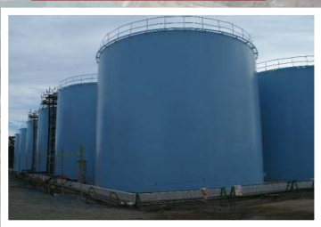
タンクの設置状況
