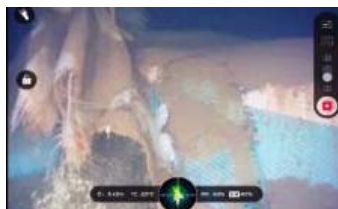
破損している土嚢(現在)
